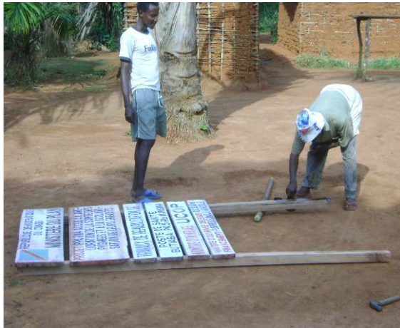
Figure 3 : Assemblage et badigonnage des pieds soutenant les panneaux par le Président du comité de suivi et évaluation de Poste de santé de BUTIABA
