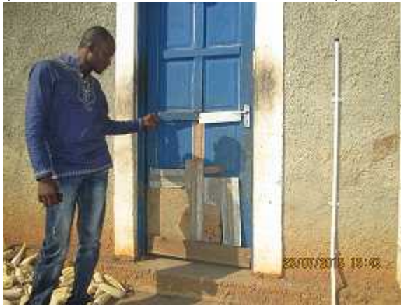
Mauvaise qualité des portes (Photo communauté locale KOKIZA)
