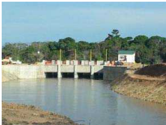
Centrale hydroélectrique de Nzoro II (Photo Kibali Gold Mines)
